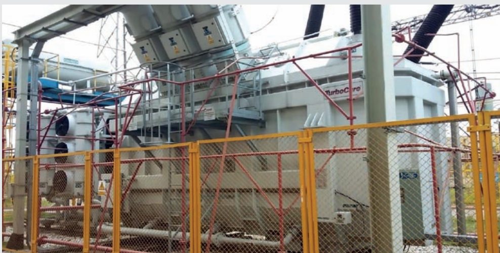
Transformator blokowy po modernizacji
