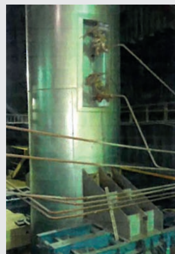
Przykład rurociągu parowego po modernizacji
