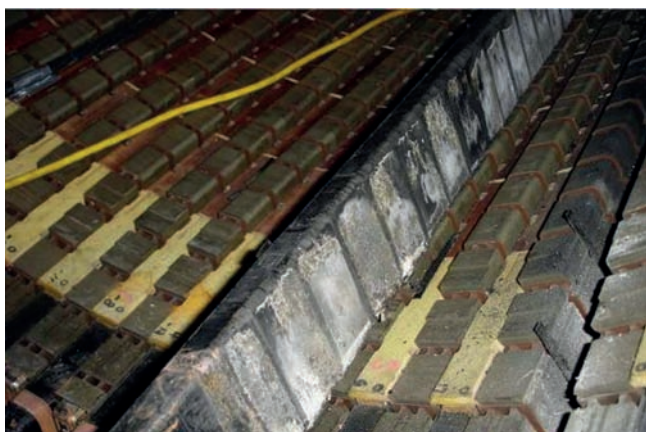
Rys. 2. Przykład zniszczonej przez WNZ powłoki półprzewodnikowej na pręcie stojana
