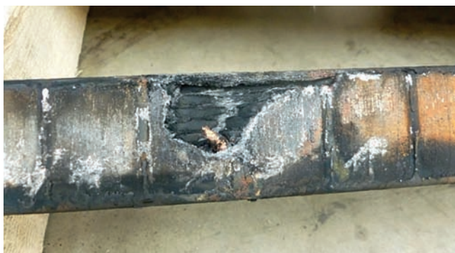
Rys. 1. Przykład uzwojenia zniszczonego WNZ, na którym doszło do zwarcia
